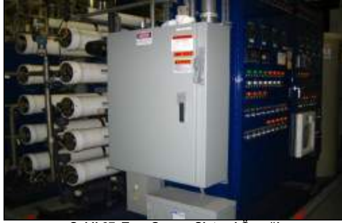
Şekil 67. Ters Osmoz Sistemi Örneği
