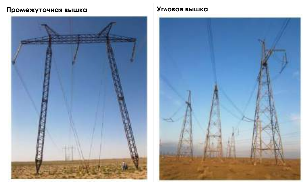
Фото 2-26 Пример типичных промежуточных и угловых вышек 500 кВ
